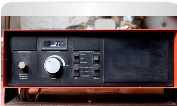
Kessel mit Kesselthermostat
