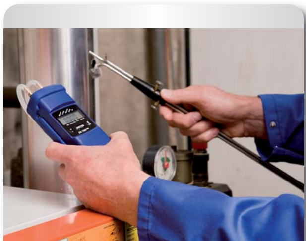
Messung am Wärmeerzeuger
